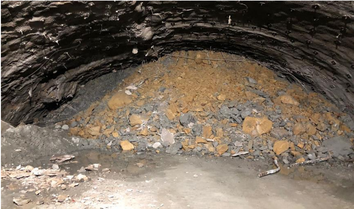
Şekil 1. T5 tüneli çıkış portal kesimi göçük bölgesi aynası
