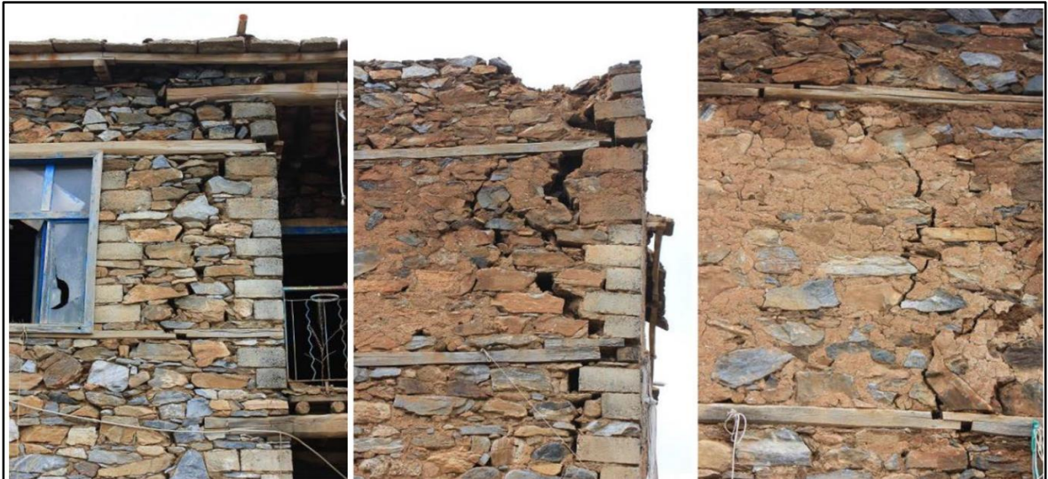
Şekil 11. Yetersiz ahşap gergi kullanımına bağlı yığma yapılarda meydana gelen hasar
