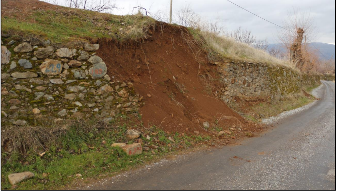
Şekil 6. Malatya ili Doğanyol İlçesinde lokal göçen bir ağırlık tipi istinat duvarı
