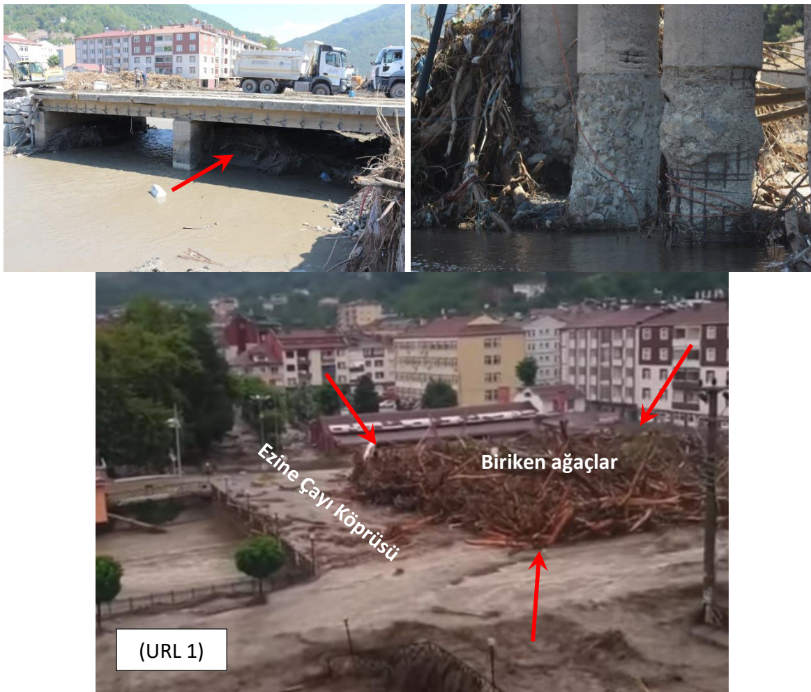
Şekil 6. Köprü ve köprü ayaklarında gözlenen hasarlar - kusurlar
