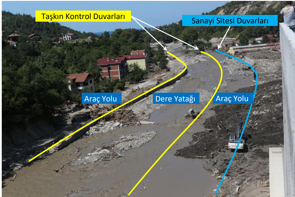
Şekil 4. Dere kenarında ıslah ve koruma amacıyla inşa edilen duvarların tamamının yıkıldığı bir bölgenin fotoğrafı
