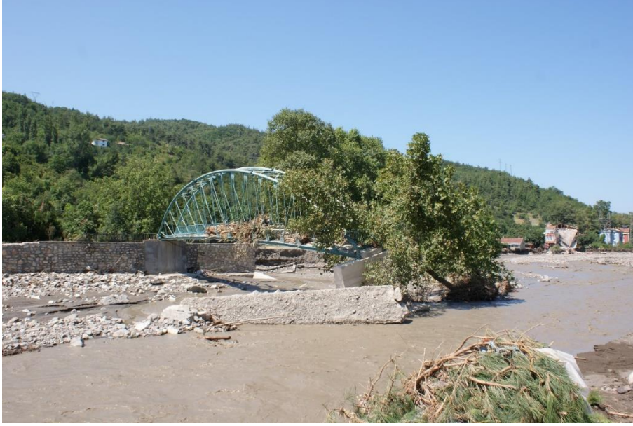
Şekil 8. Bozkurt ilçesinde, bir ayağında oyulmaya bağlı hasar oluşan yaya köprüsü
